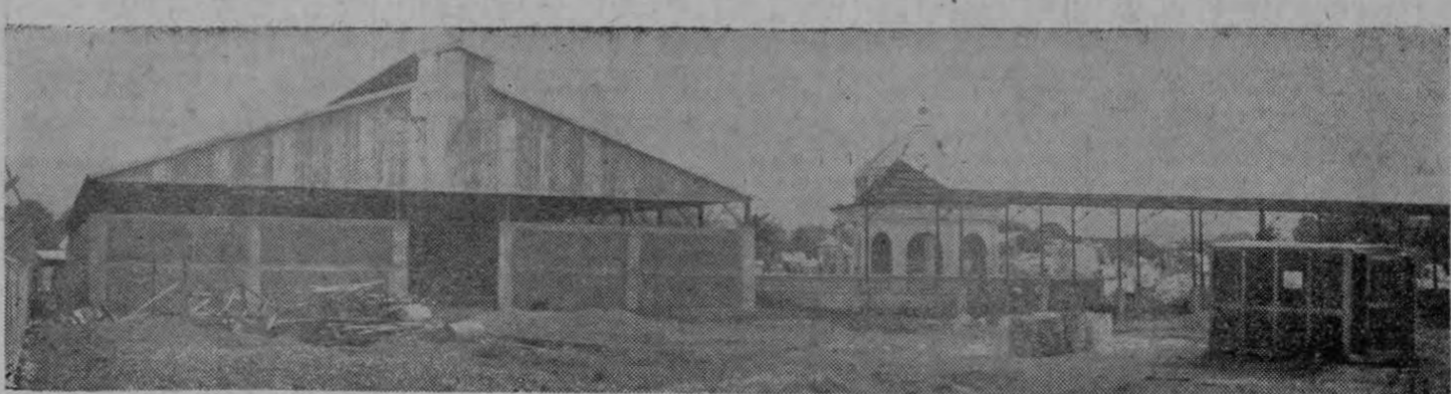
Puede verse en el lado izquierdo el edificio que servirá de garage y taller de reparación de los vehículos del Ministerio de Agricultura; y a la derecha el gran galerón que se construye para bodega de materiales. Ambos estarán listos el próximo mes.
